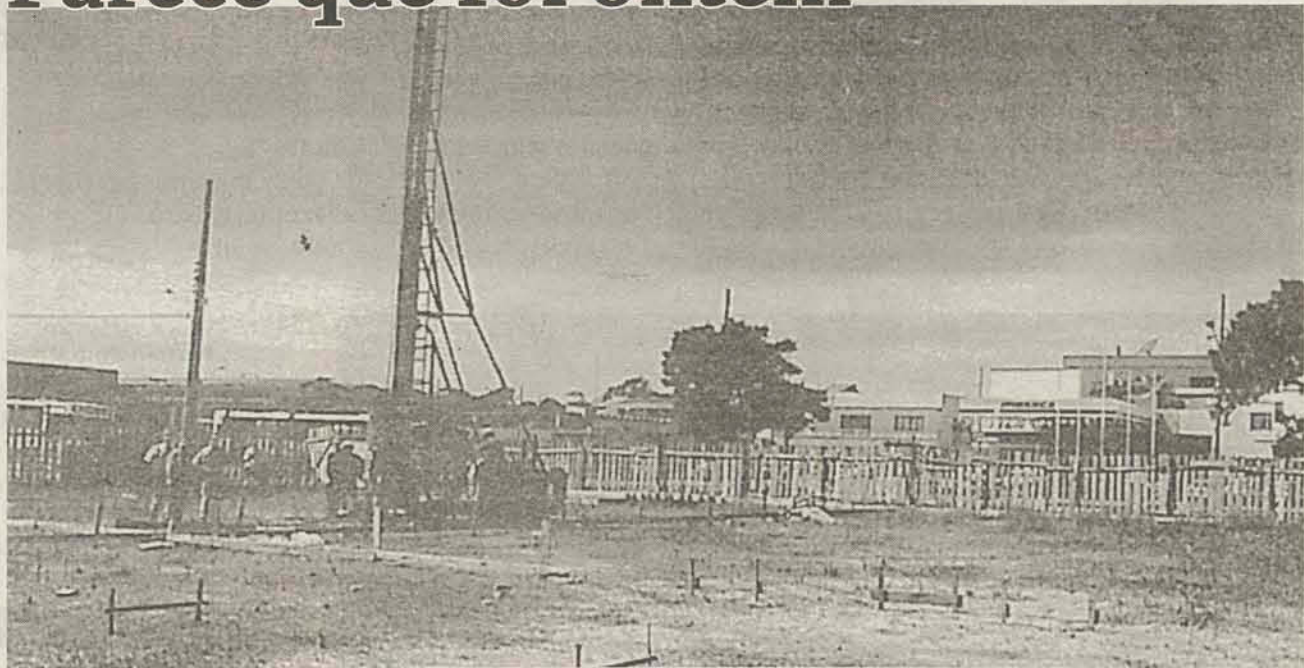
Área que habitou as Indústrias Pedone, depois a indústria de Pescados dos Madeira e mais tarde a New York Sound. Na foto, nos anos 90, quando recebia estaqueamento para construção do Centro Administrativo e Comercial Tordesilhas.
